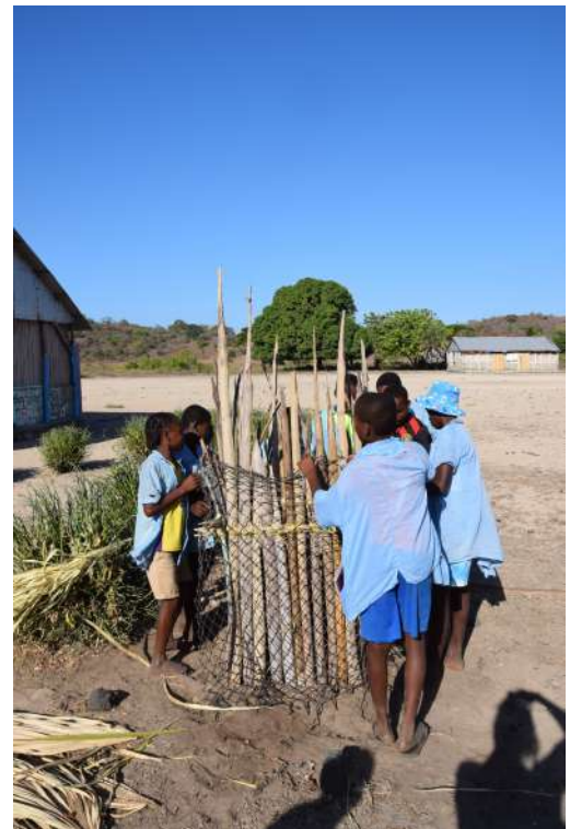
Construction et mise en place par les élèves d'un filet et d'une barrière de protection des plants pour éviter la destruction par les animaux (Zébus, chèvres...)
