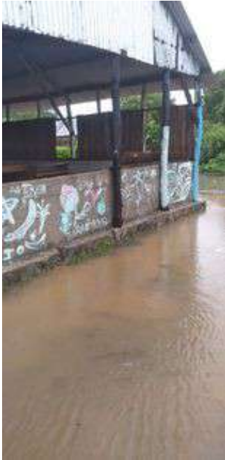
Inondation et murs du collège arrachés après le passage d'un cyclone
